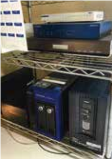
セキュリティサーバー などのラック
